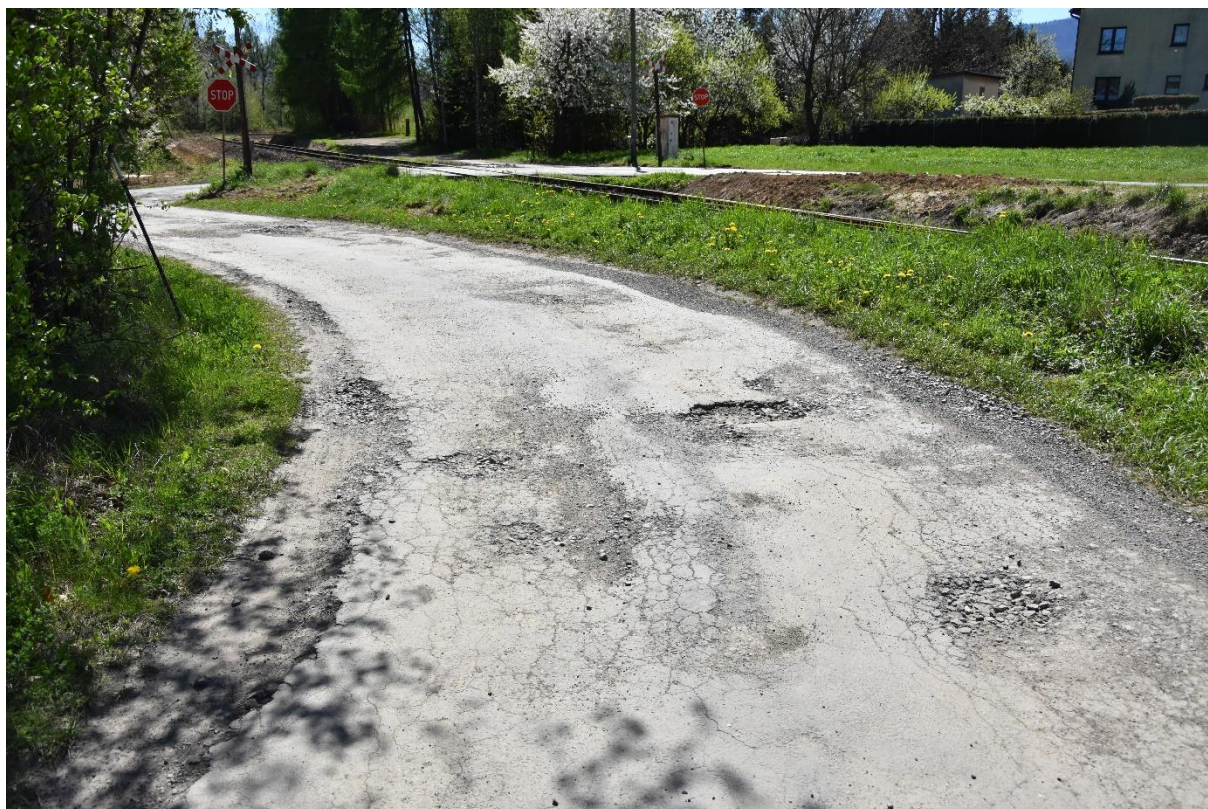
Zdjęcie 37. Ulica Pszenna w Goleiszowie zniszczona w trakcie prac modernizacyjnych linii kolejowej 191
