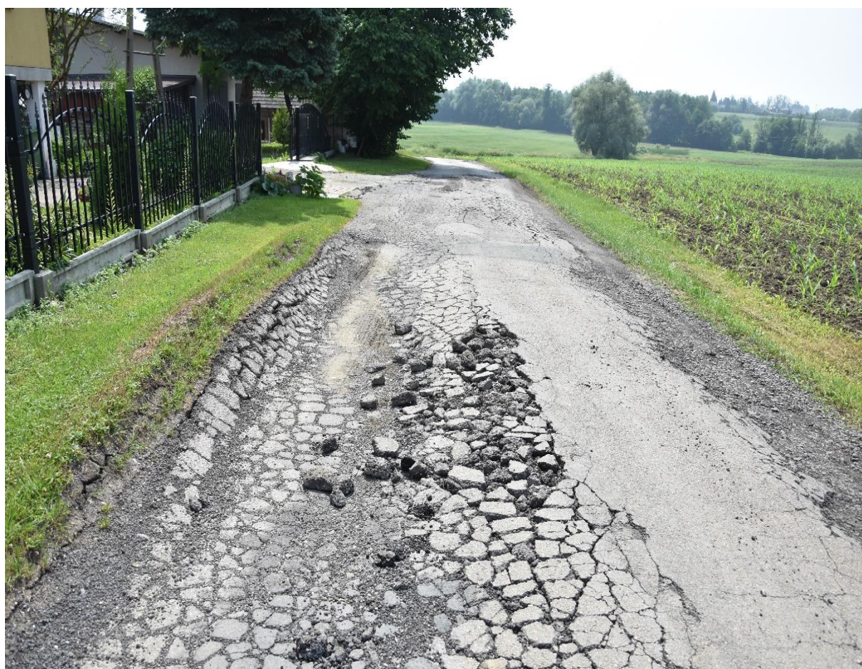
Zdjęcie 36. Ulica Folwarczna w Bażanowicach zniszczona w trakcie prac modernizacyjnych linii kolejowej 190
