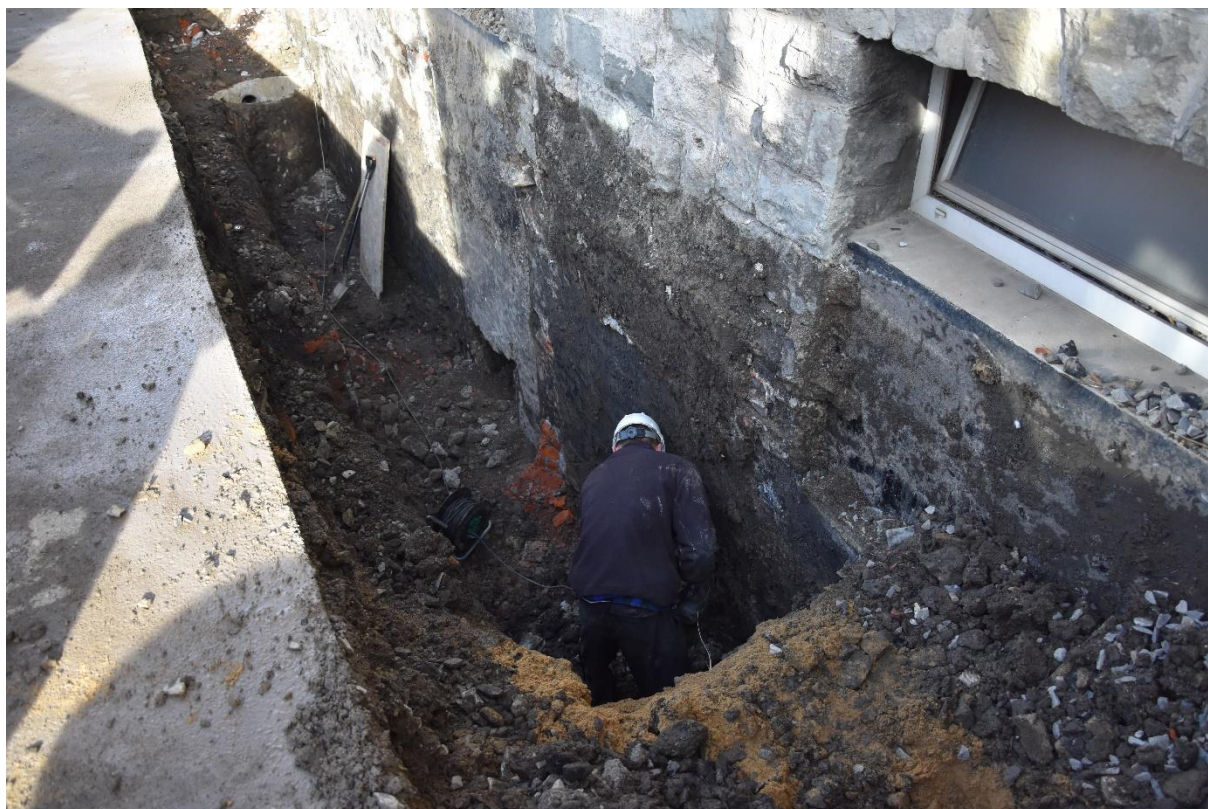
Zdjęcie 33. Izolacja ścian zewnętrznych Gminnego Ośrodka Kultury w Goleszowie Źródło: Urząd Gminy Goleszów.
