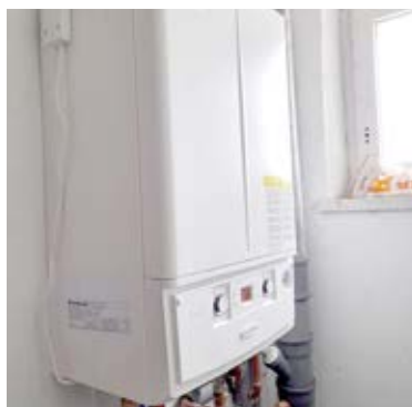
Zdjęcie 47. Instalacja c.o. w budynku LKS Goleiszów. Źródło: UG Goleiszów.
